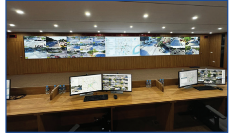
Hệ thống giám sát giao thông thông minh tại tỉnh Nghệ An
