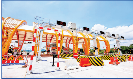
Hệ thống thu phí trên tuyến đường cao tốc Tiên Yên – Móng Cái
